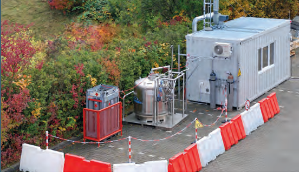
Testanlage für kryogene Brennstoffe in Außencontainer
